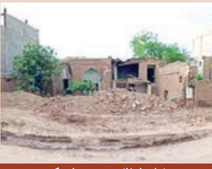
نمایی از خانه حمید سبزواری که چندی پیش بخشی از آن تخریب شد
