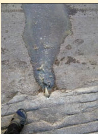
معضل رهاسازی فاضلاب خانگی در خیابان های ناحیه ۲
