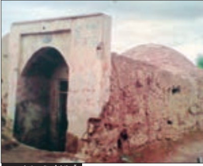
آب انبار فروتقه پیش از مرمت
