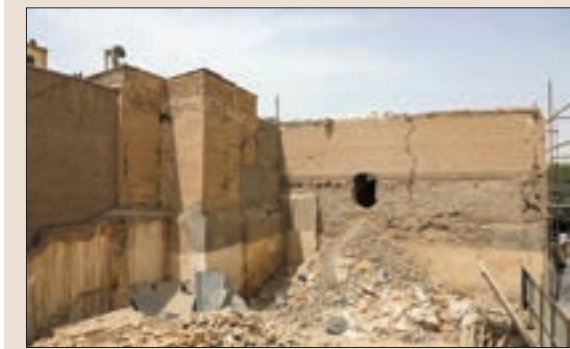
آسیب‌های پشت سرای عزیزا...اف در قسمت آب انبار
