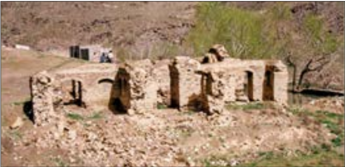
نمای از ضلع شرقی که بقایای دیوارهای تخریب شده در آن دیده می‌شود
