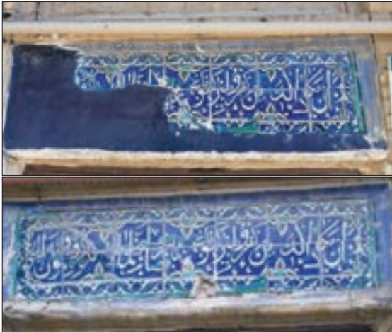
تصویری کامل از کتیبه ورودی خانه که حالا بخشی از آن تخریب شده است
